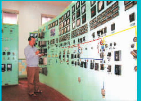
南丰电站机房中央控制室
