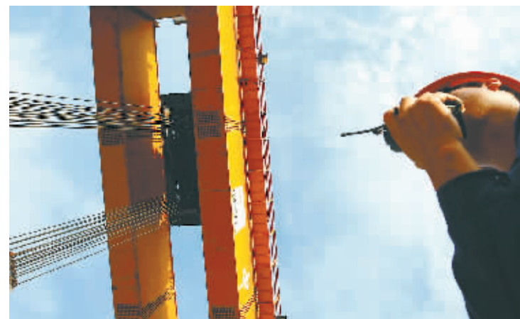
9月17日,中铁二十五局东环铁路万宁制梁场,工作人员正在指挥提梁机将一片预制700多吨重箱梁吊装到存梁区。
