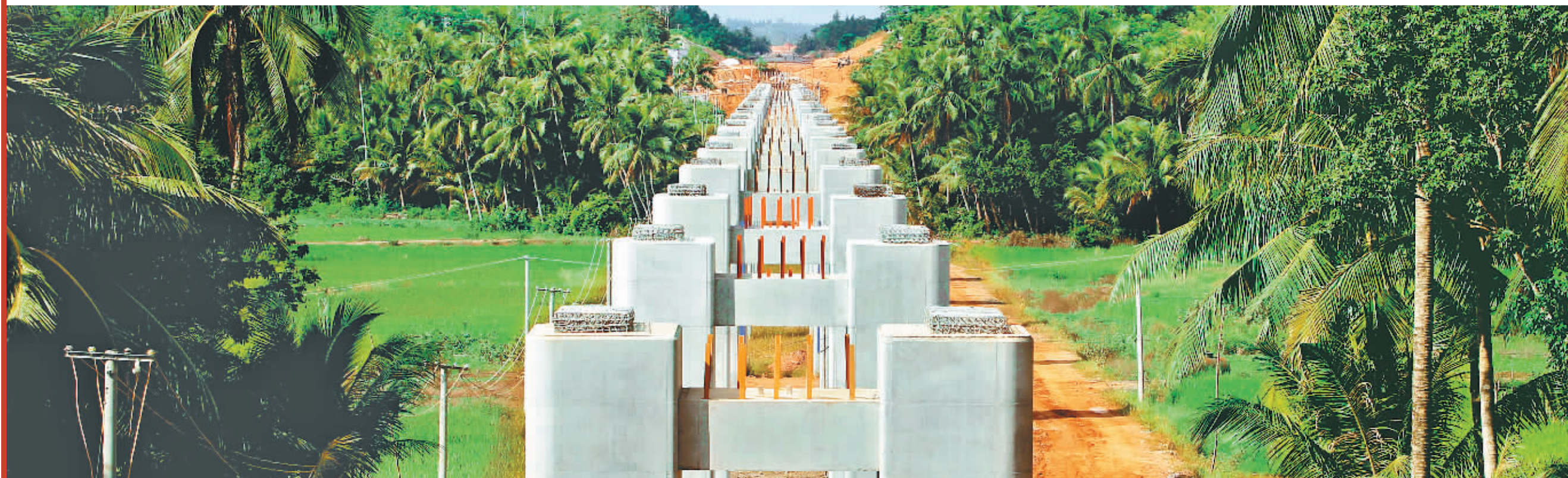
9月23日,文昌市文城镇迈号办事处。一片郁郁葱葱的田野和椰子树环抱中,已完成下部结构、全长742米的东环铁路迈号头特大桥桥墩“一”字排开,伸向远方。
