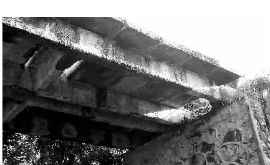
→危桥钢筋裸露,桥面破损严重。本报记者李关平摄
