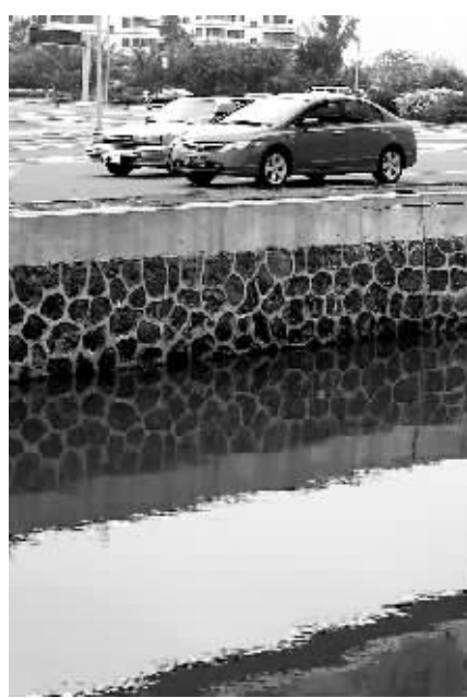
海甸五西路海甸沟没有护栏存在安全隐患。 本报记者 李英挺 摄
