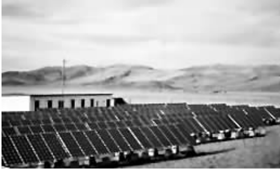
英利集团四川阿坝独立光伏电站
