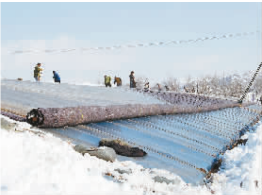
暴雪压塌大棚
