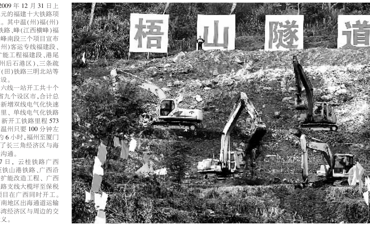
2009年12月31日，工程机械在(肥)福(州)铁路客运专线福建段梧山隧道现场作业。新华社记者 张国俊 摄
