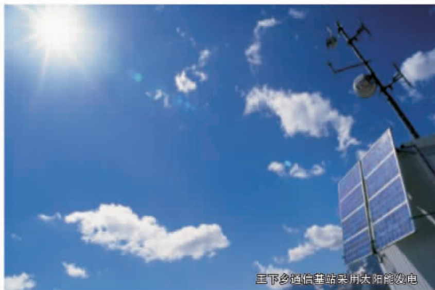
王下乡通信基站采用太阳能发电
