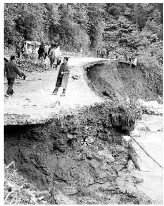
5月8日拍摄的湖南省娄底市新化县奉家镇被冲毁的公路。
