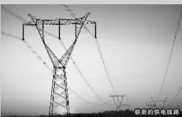
崭新的供电线路
