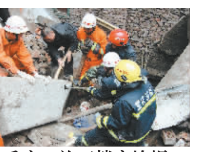
重庆一施工楼房垮塌 1人死亡14人受伤
