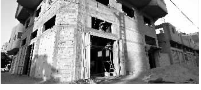
这是2010年7月5日在加沙城拍摄的一栋被毁建筑。
