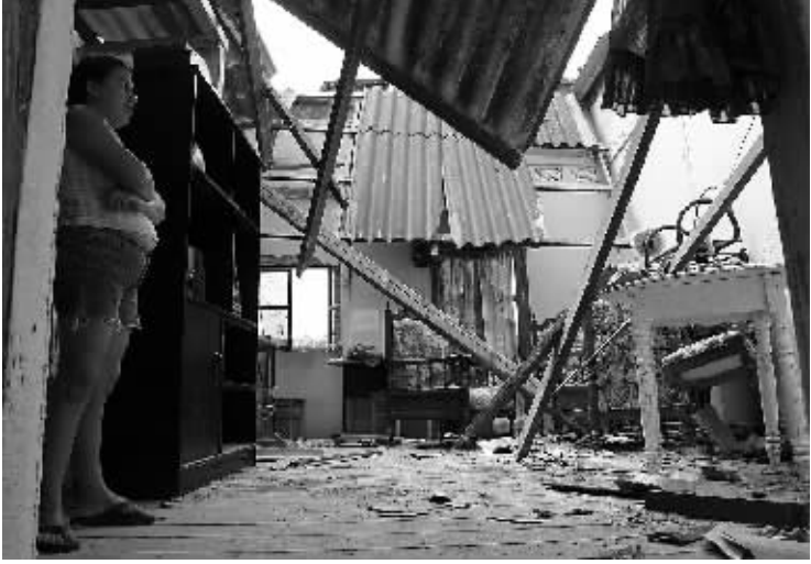
8月12日，在厄瓜多尔曼塔，一位妇女看着被地震毁坏的房屋。据中国国家地震台网测定，厄瓜多尔中部12日发生里氏7.1级地震。 新华社/法新
