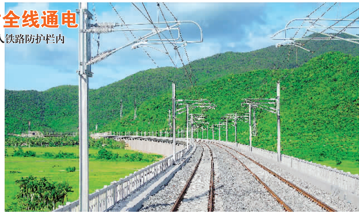
9月10日,朝阳下的海南东环铁路电力接触网。 本报记者 古月 摄
