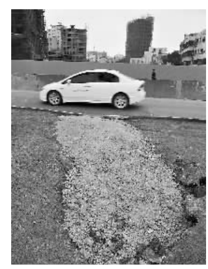
海口滨江路滨江亭小区路段出现路面塌陷。本报记者王凯摄
