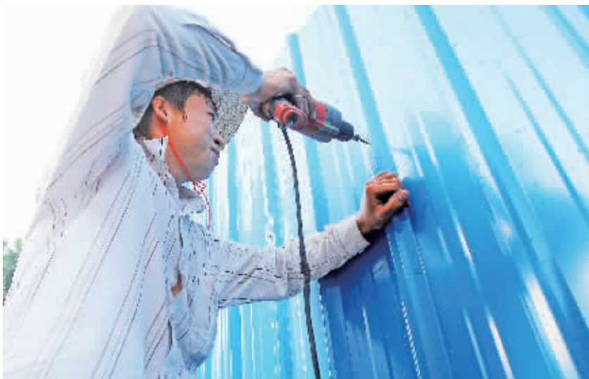
9月14日,海口市龙昆南路道客村路段,施工人员正在设置围挡,为道客村人行天桥项目做施工前准备。
