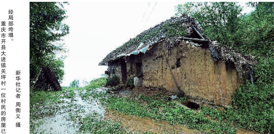
经局部垮塌。重庆市开县大进镇关坪村一位村民的房屋已
