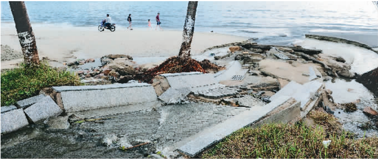
10 月 11 日, 三亚湾海月广场附近, 被大雨冲毁的人行道。
