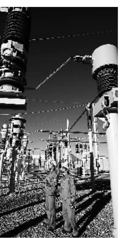
12月9日,两名电力工人在青藏联网工程±400千伏拉萨换流站巡视设备。
