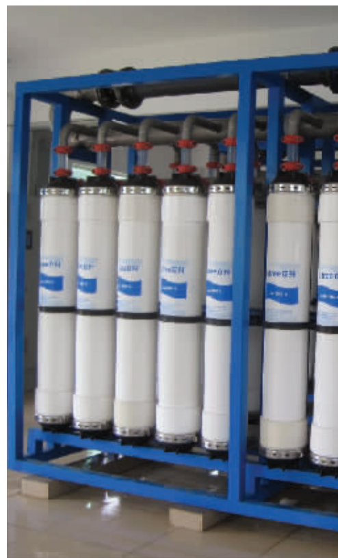
会文自来水厂安装的超滤膜净水器
