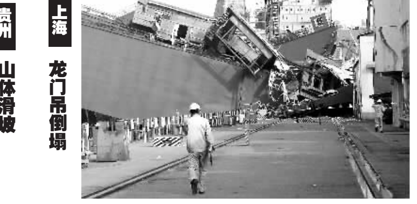
上海 龙门吊倒塌
