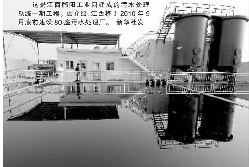
这是江西鄱阳工业园建成的污水处理系统一期工程。据介绍,江西将于2010年9月底前建设80座污水处理厂。新华社发
