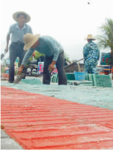
三亚市今年加大资金投入,对各镇墟集市主要街道进行改造,重建排水管道设施,铺设彩色瓷砖,安装路灯等,为各镇墟居民创造方便、舒适的居住生活环境。图为施工人员近日在天涯镇镇墟加紧铺设街道两旁的人行道。 本报记者 程范淦 摄影报道
