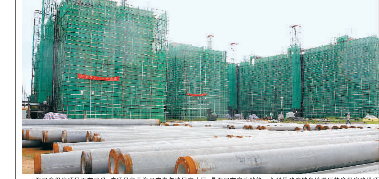
海口廉租房项目正在建设。该项目位于海口市青年路民安小区,是海口市启动的第一个利用政府储备地进行的廉租房建设项目。项目建有670套廉租住房和446套经济适用房,计划今年9月底完工。 本报记者 王凯 摄
