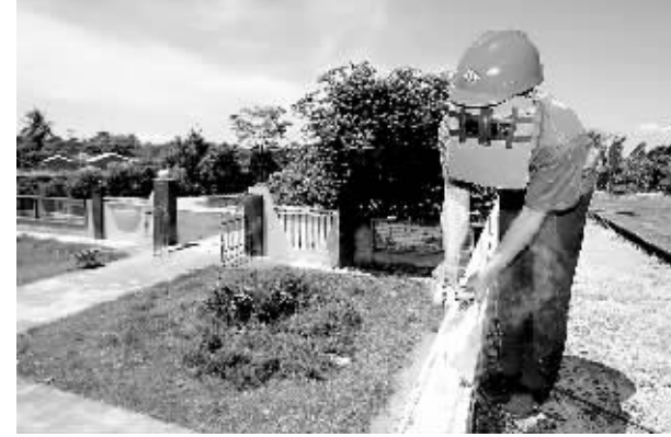
8月29日,屯昌县屯城镇大石小学校园内,一名工人正在安装避雷装置。
