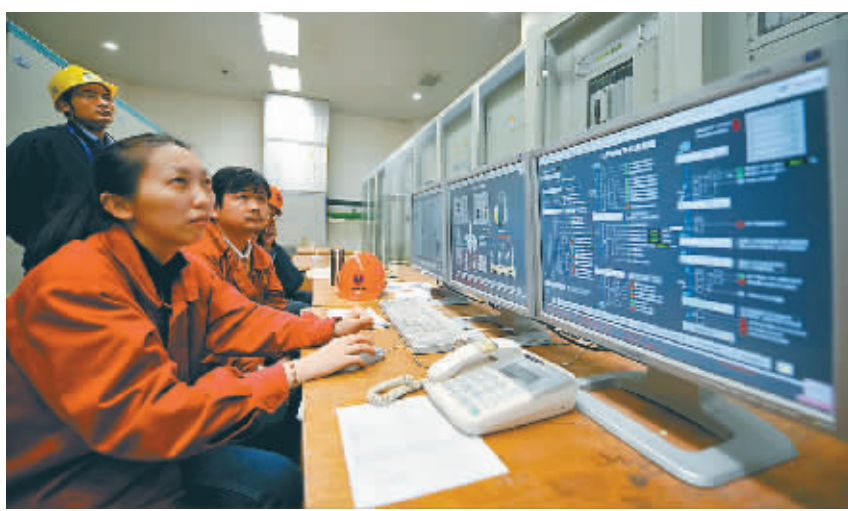
10月30日,工作人员在控制室操作15号发电机组并网发电。新华社记者 郝同前 摄
