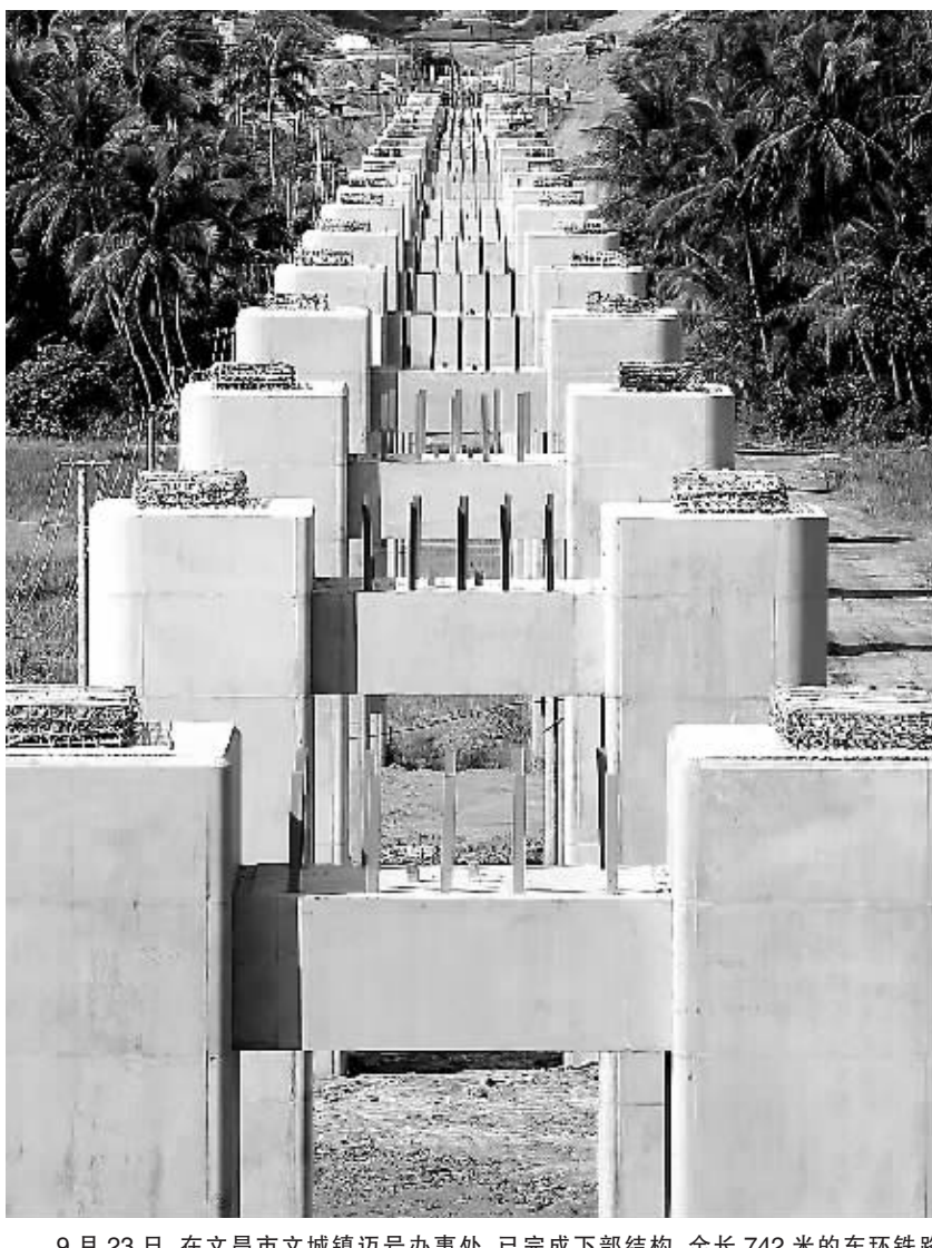
9月23日,在文昌市文城镇迈办事处,已完成下部结构、全长742米的东环铁路迈仍头特大桥桥墩“一”字排开伸向远方。本报记者 宋国强 摄
