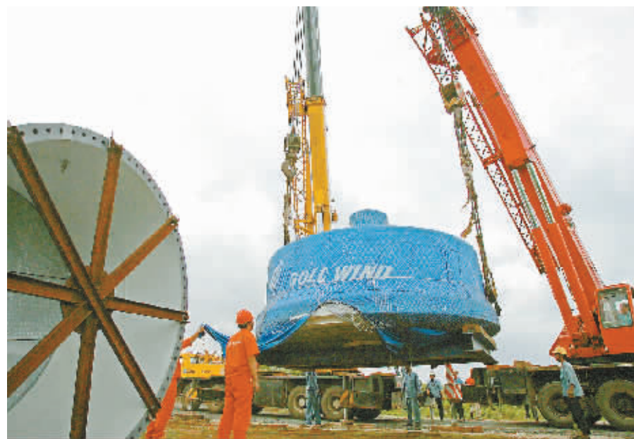
5月7日,儋州峨蔓风电场项目施工现场,风电机组运抵现场准备安装,我省第一个清洁能源项目——峨蔓风电场一期工程项目目前已进入吊装阶段。 本报记者 李英挺 摄
