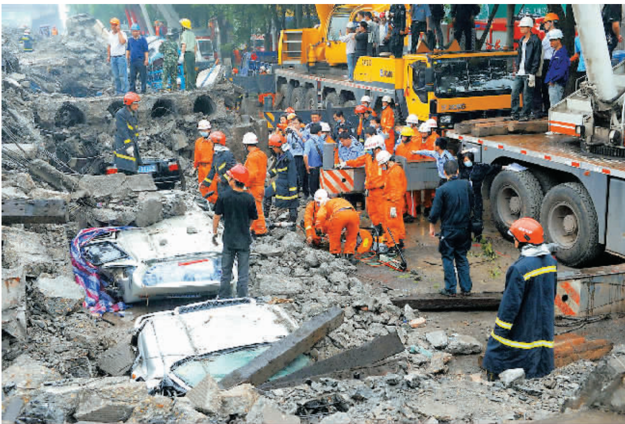
坍塌事故搜救现场。新华社记者 龙弘涛 摄
