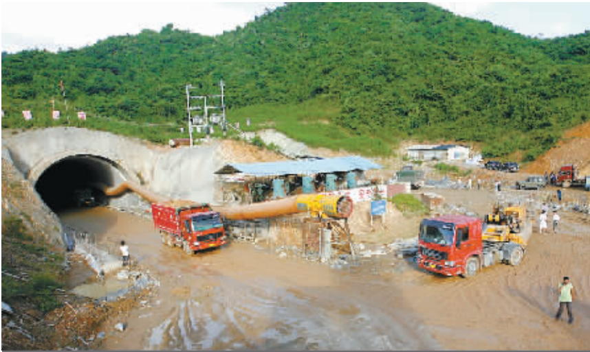
发生塌方的隧道。本报记者 程范滢 摄
