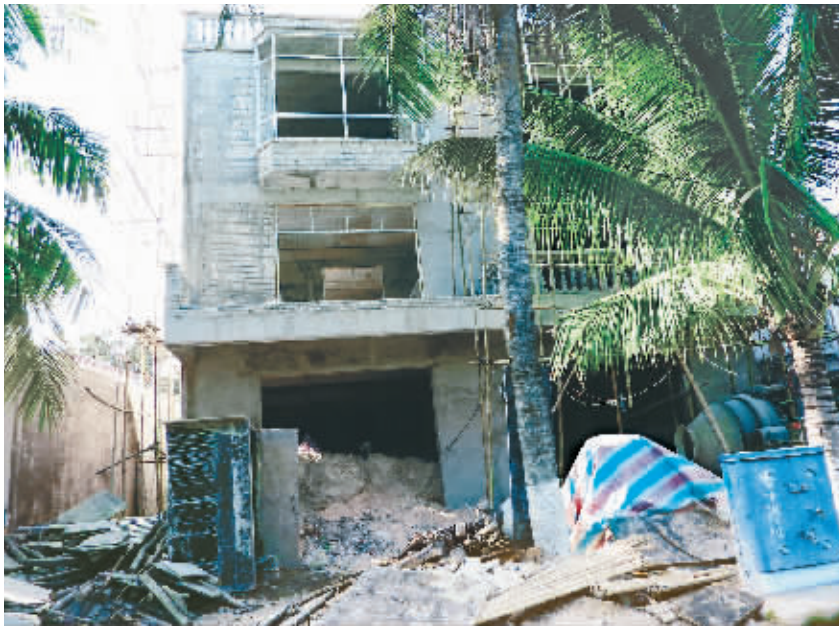
鹿回头村正在抢建的违章建筑。
