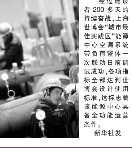
经过建设者200多天的持续奋战,上海世博会“城市最佳实践区”能源中心空调系统带负荷整体一次联动日前调试成功。
