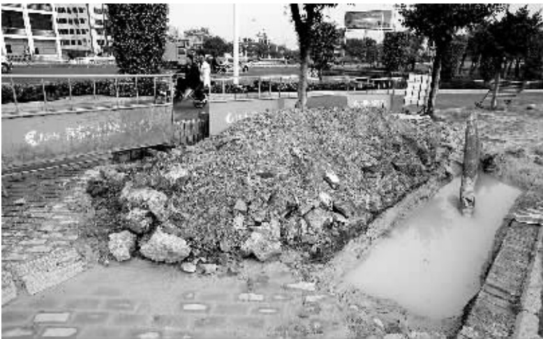
在海府路与国兴大道交汇处,一条人行道被违规开挖施工。
