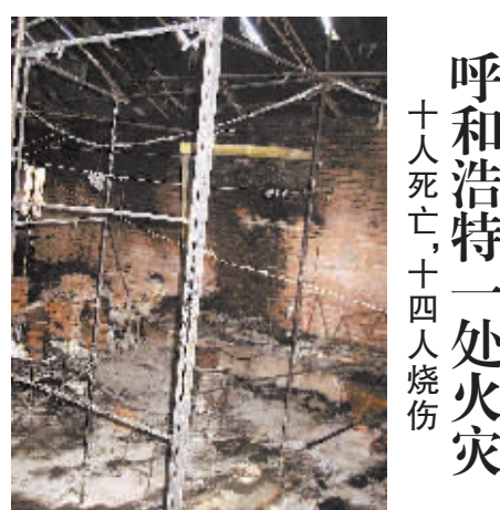
呼和浩特一处火灾现场。5月3日22时30分左右,位于呼和浩特市赛罕区榆林镇二道河村的一处铁路隧道施工人员住所发生火灾,据初步核实,火灾已造成10人死亡,另有重度和轻度烧伤人员14名。
