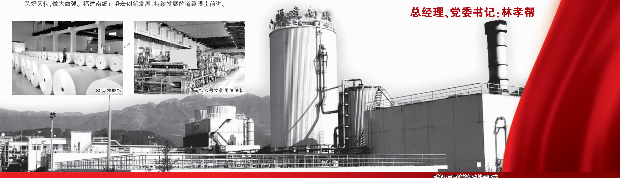
日处理三万吨的污水处理系统
