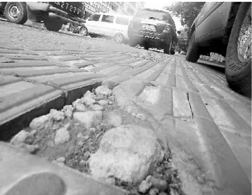
经过车辆碾压的人行道地砖破损不堪。
