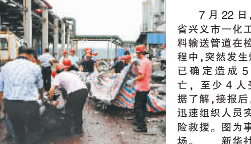
7月22日,贵州兴义市一化工厂原料输送管道在检修过程中,突然发生爆炸,已确定造成5人死亡,至少4人受伤。据了解,接报后,当地迅速组织人员实施抢险救援。图为事故现场。新华社发
