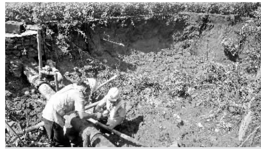
海口市滨海大道绿化带出现塌方,具体原因相关部门正在进一步勘察中。本报记者 李英挺 摄
