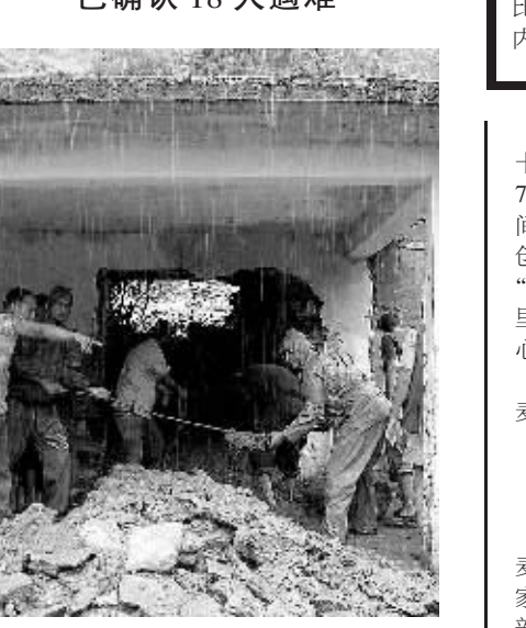
8月18日,在印度西北部阿肯德邦巴盖什沃尔地区的一所农村小学,人们在屋顶坍塌事故现场救援。当天,这所小学发生屋顶坍塌事故,造成正在上课的25名学生被埋,目前已确认18名学生遇难。 新华社/路透
