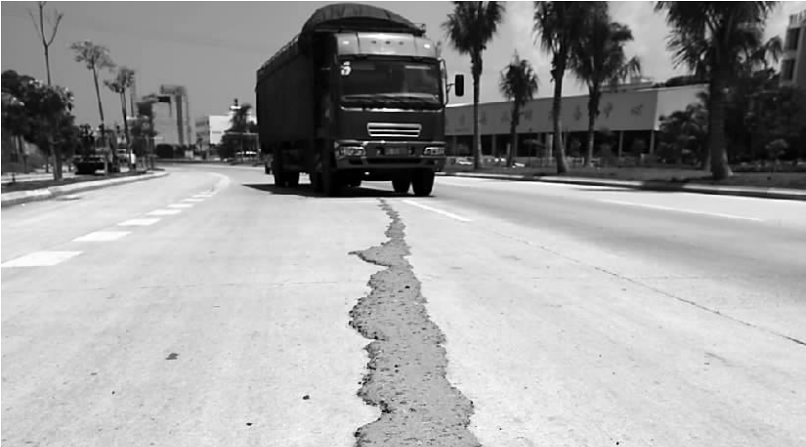
椰海大道路面上凸起的水泥疙瘩让过往车辆不得不避让行驶。本报记者 张杰 摄
