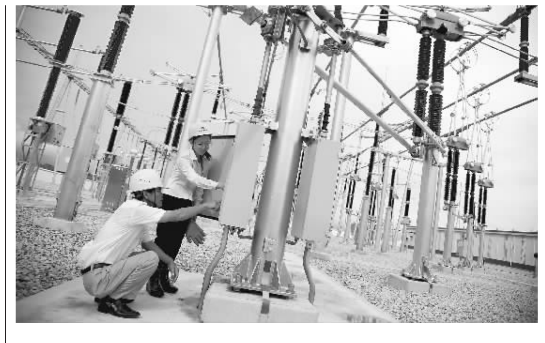
为东环铁路提供用电保障 陵水文罗220千伏变电站送电成功
