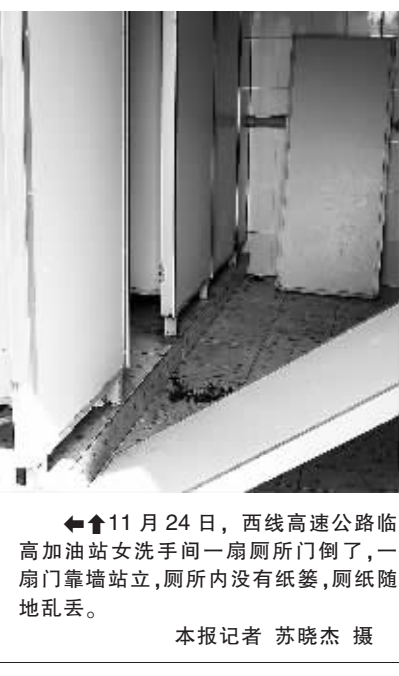
11月24日,西线高速公路临高加油站女洗手间一扇厕所门倒了,一扇门靠墙站立,厕所内没有纸篓,厕纸随地乱丢。
