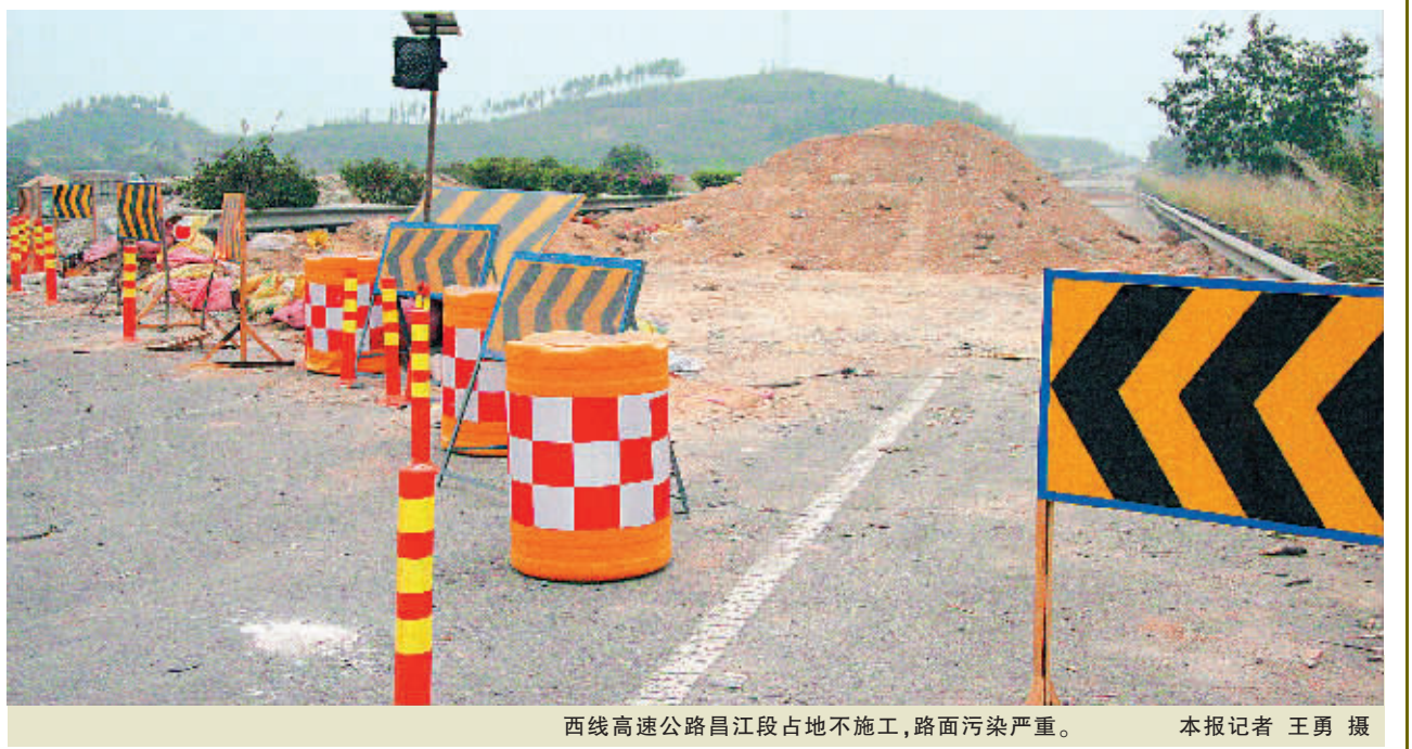
西线高速公路昌江段占地不施工,路面污染严重。 本报记者 王勇 摄
