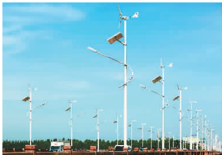
海口新大洲大道两旁安装的风光互补路灯。
