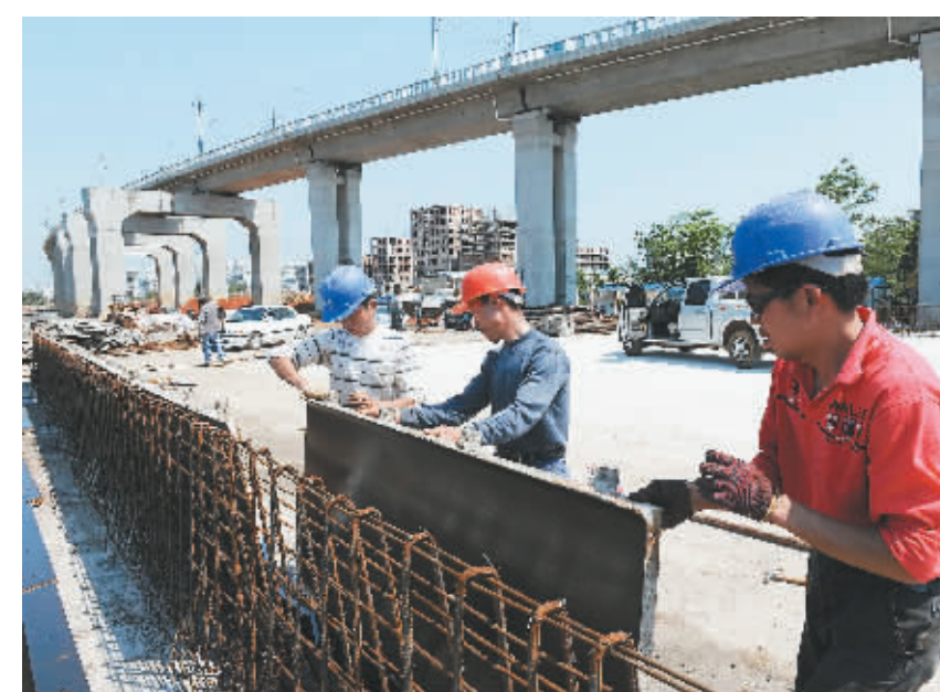
3月21日,工人正在海口市美舍河大桥上进行大桥护栏浇筑的前期工作。
