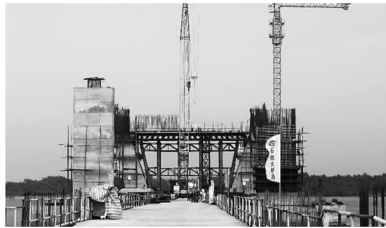
4月5日,文昌市重点项目之一的清澜大桥正在进行主塔下横梁施工。据悉,清澜大桥为钻石型双塔双锁钢混叠合梁斜拉桥,总投资4亿多元,目前完成投资约1.5亿元,预计明年5月份竣工通车。 本报记者 王凯 摄
