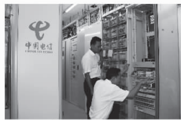
中国电信员工检测通信保障设备
