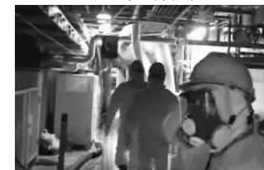
东电工作人员进入福岛第一核电站一号机组涡轮机房。
