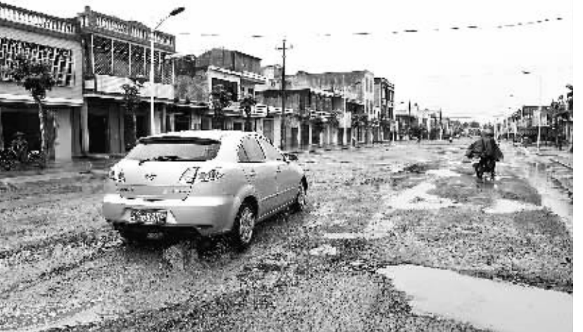
6月23日，琼海市潭门镇的主干道上损坏的路面积满了雨水，坑洼难行。本报记者王凯摄
