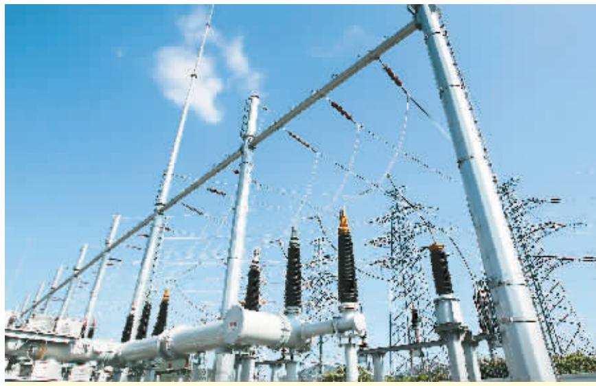
7月27日,110千伏茅通线路改造工程竣工送电。 本报记者 李英挺 摄
